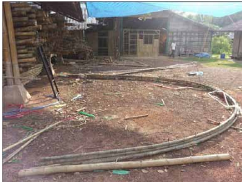
รูปที่ 3 การเตรียมงานก่อสร้างอาคารไม้เฟรมแบบ กึ่งสำเร็จรูป
